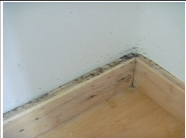
Fig. 2: Schimmel in der unteren Wandecke
