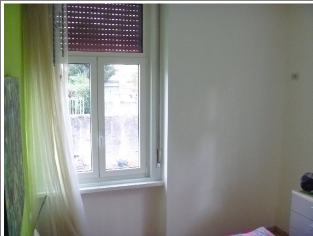
Fig. 4: Die Oberflächentemperaturen sind in der Nische und in den Ecken zu niedrig.
